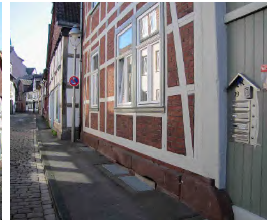
Nebeneinander sanierter Gebäude und Leerstände mit erheblichen Sanierungsbedarf ▲
